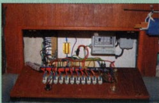
Le tableau électrique très propre s'ouvre sur le carré.
