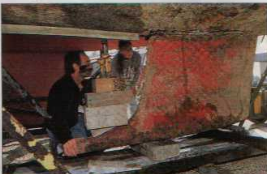
Dès le prochain numéro, vous découvrirez l'évolution des travaux (nous avons pris un peu d'avance avant l'hiver). Au programme, le démontage de l'accastillage, des accessoires et du safran et de la quille (ci-dessus).
