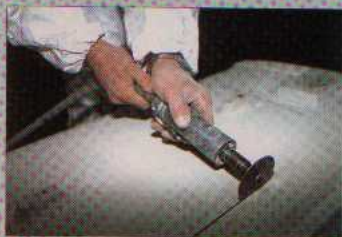
Attention ! Cette petite scie circulaire découpe tout sur son passage, y compris le pont !
