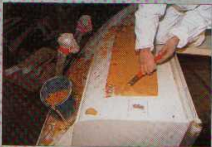
Commence alors l'opération de grattage de la mousse au ciseau. Facile mais laborieux !
