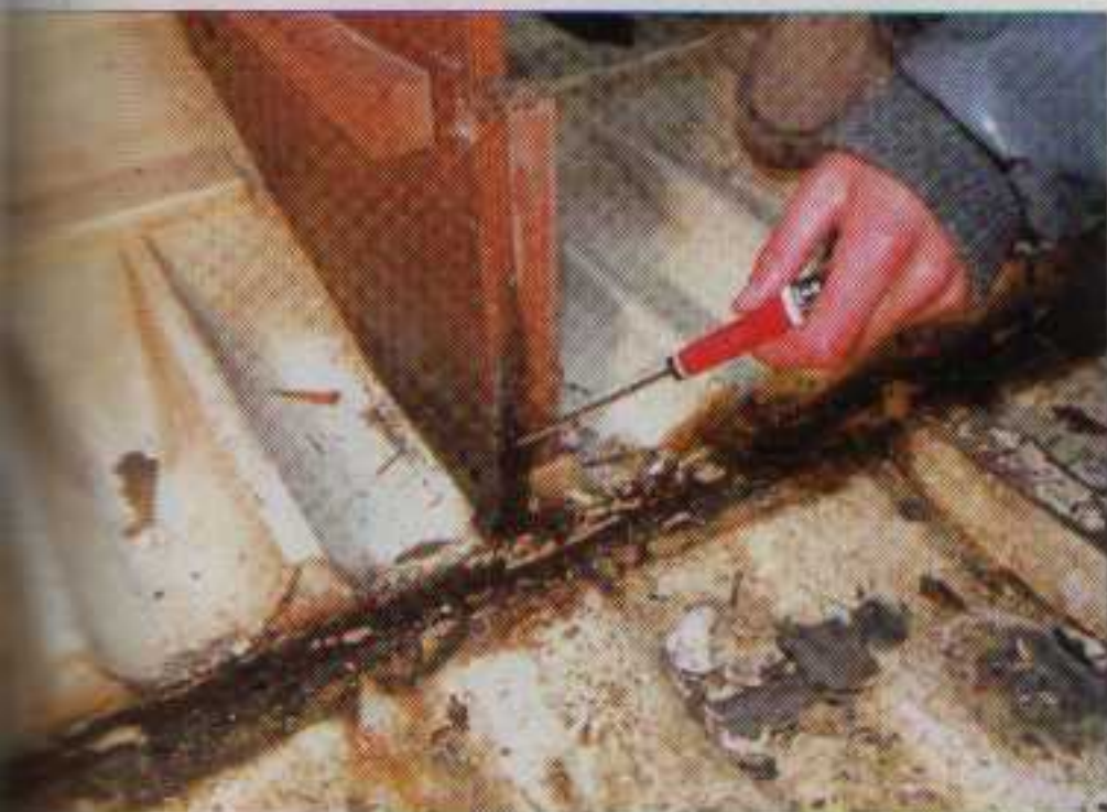
Les chants des cloisons sont parfois pourris par l'humidité.
