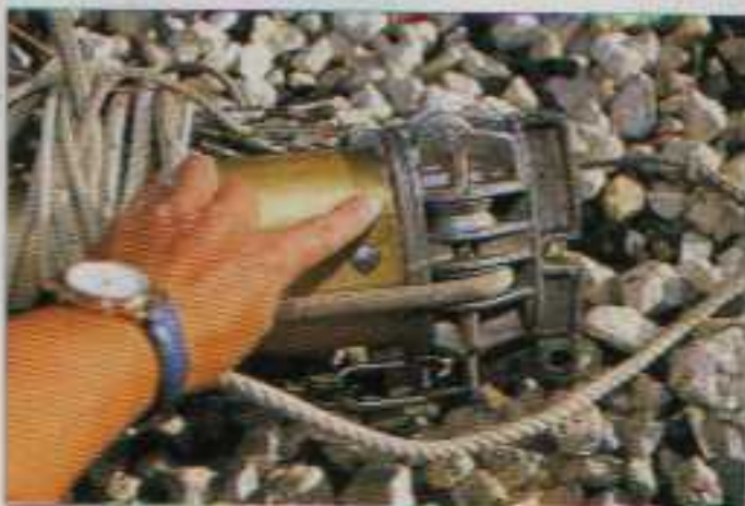
Au pied de mât, on peut déceler des traces de corrosion sur le tube et la pièce moulée.
