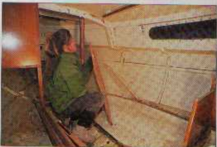
Le rouf est affaissé au niveau des cloisons.
