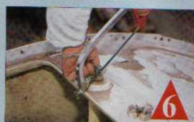
6 Au final, il faudra encore scier les extrémités de l'axe inox qui s'est tellement tordu qu'il ne peut sortir de son logement.
