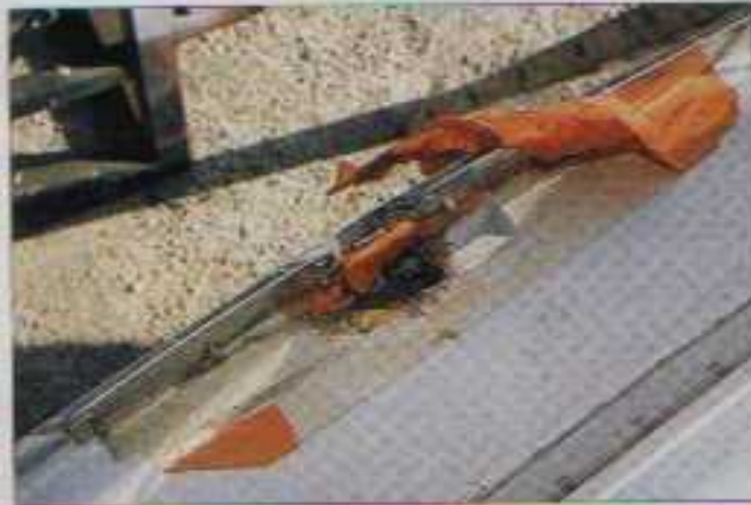
Au niveau des pieds de chandeliers, à l'origine moulés dans le pont : un vrai désastre !
