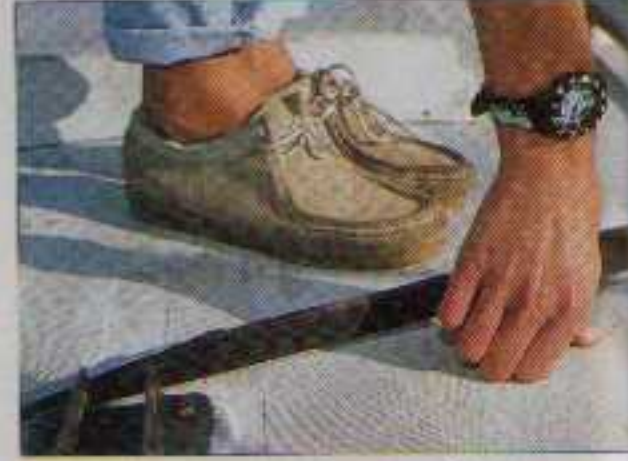
Le pont en sandwich est entièrement délaminé et « bouge » sous les pieds...
