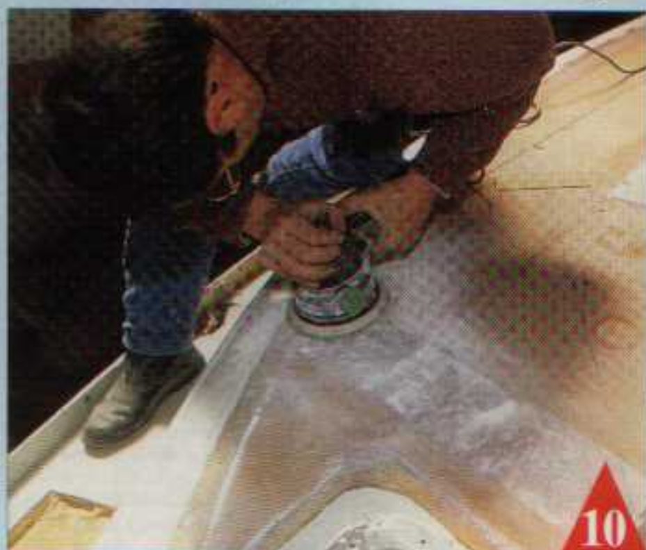
10 Un ponçage à la vibrante est indispensable vu la surface de « choucroute » et le nombre de raccords de mousse.
