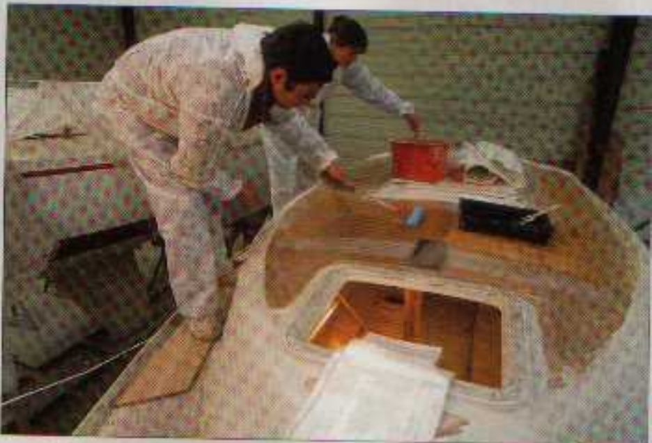
Une fois la résine polyester mélangée à son catalyseur (2%), il suffit de l'étendre au rouleau directement sur la mousse.
