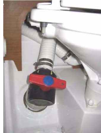
Vanne d'évacuation WC à la mer
