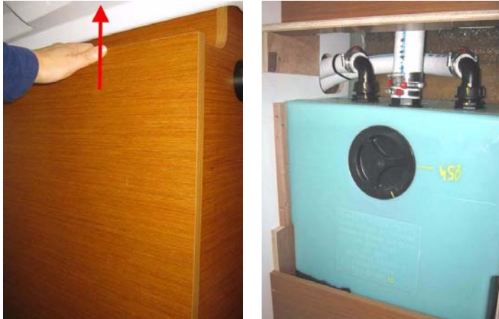
Réservoir eaux noires Implantation : Salle d'eau Capacité : 80A
