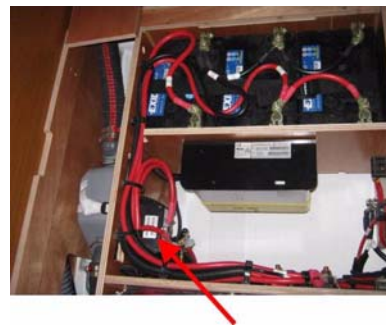
Implantation : Cabine arrière bâbord
