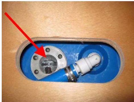
Jauge (Située directement sur le réservoir)
