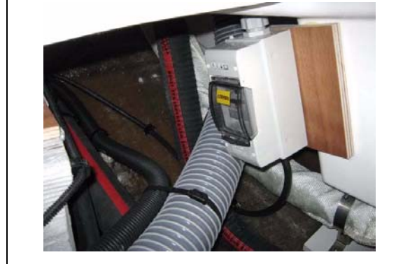
Interrupteur - AC (Repère 2)
