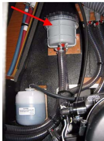
Filtre eau de mer Implantation : Compartiment moteur
