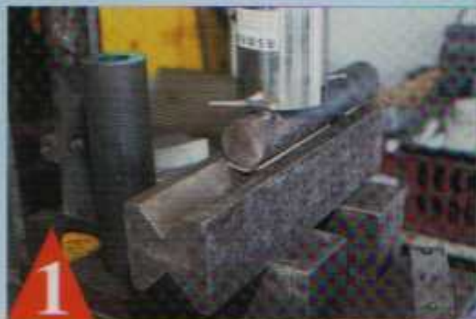
1 C'est à l'aide d'une presse hydraulique de 12 tonnes que l'on plie les tôles inox 316 L.
